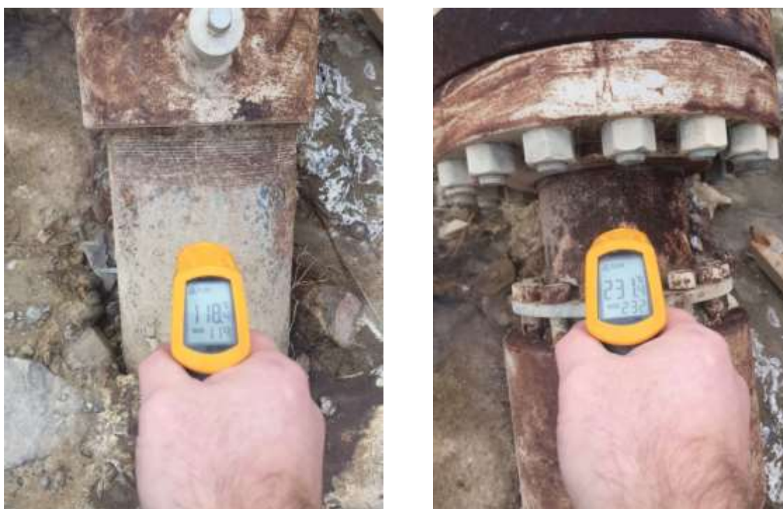
Рисунок 6. Измерение температуры обсадных колонн на устье нагнетательных скважин
