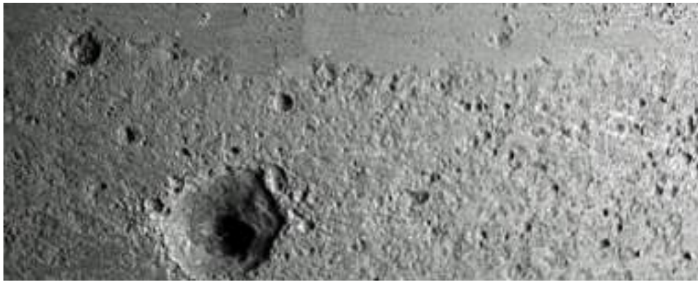
Рисунок 8 – Локальная коррозия внутренней поверхности ТССН Ø325×9 мм Западно-Салымского месторождения
