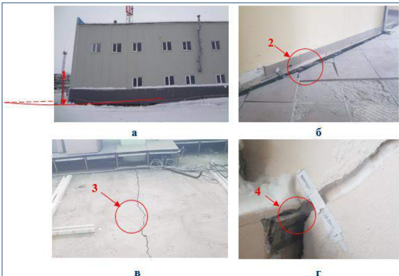
1 – деформации фундаментов и колонн каркаса, вызванные неравномерной осадкой грунтов основания; 2 – осадка конструкций перекрытия 1-го этажа; 3 – трещины в узлах крепления стеновых керамзитобетонных панелей, вызванные неравномерной осадкой колонн здания; 4 – осадочные трещины в бетонном полу из-за просадки грунтового основания а – стена здания; б – перекрытие 1-го этажа; в – опора эстакады; г – узел крепления панели к колонне
