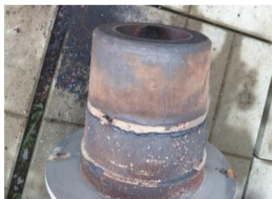
Рисунок 2 – Растрескивание горелочного устройства подогревателя газа вследствие повышенных температурных напряжений
