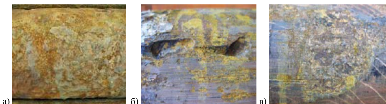
а) общая; б) питтинговая; в) коррозия пятнами
