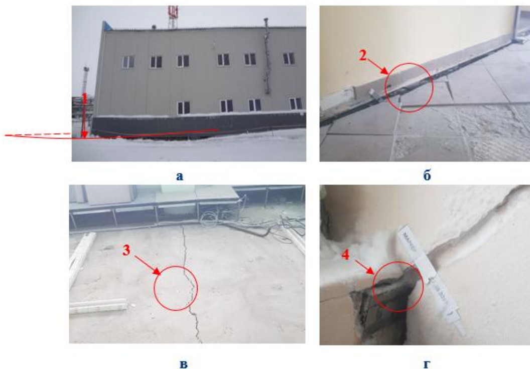
а) – стена здания; б) – перекрытие 1-го этажа; в) – опора эстакады; г) – узел крепления панели к колонне
