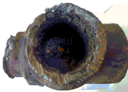
Рисунок 2 – Коррозия внутренней поверхности
