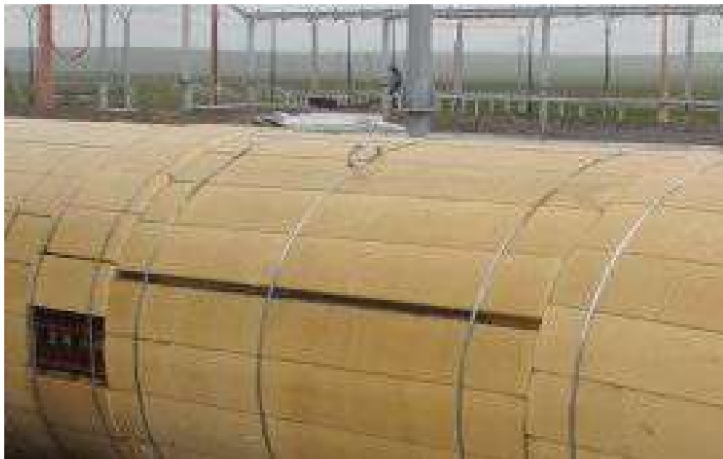
Рисунок 1 – Пример нарушения целостности сборного трубного теплоизоляционного покрытия, формируемого при монтажных работах.
