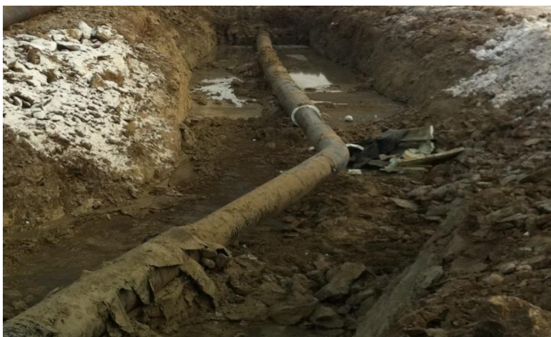
Рисунок 4 - Общий вид аварийного участка
