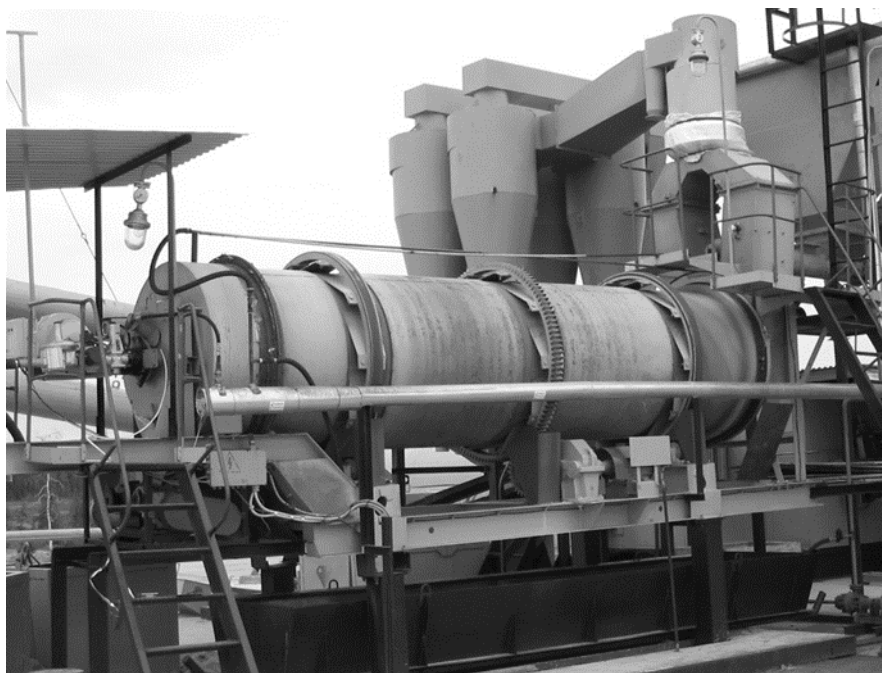
Рисунок 3 - Общий вид вращающейся газовой печи для термического уничтожения нефтешламов и нефтезагрязненных почв
