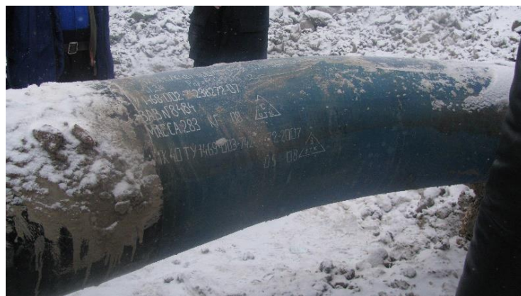
Рисунок 3 - Деформированный отвод 21^\circ
