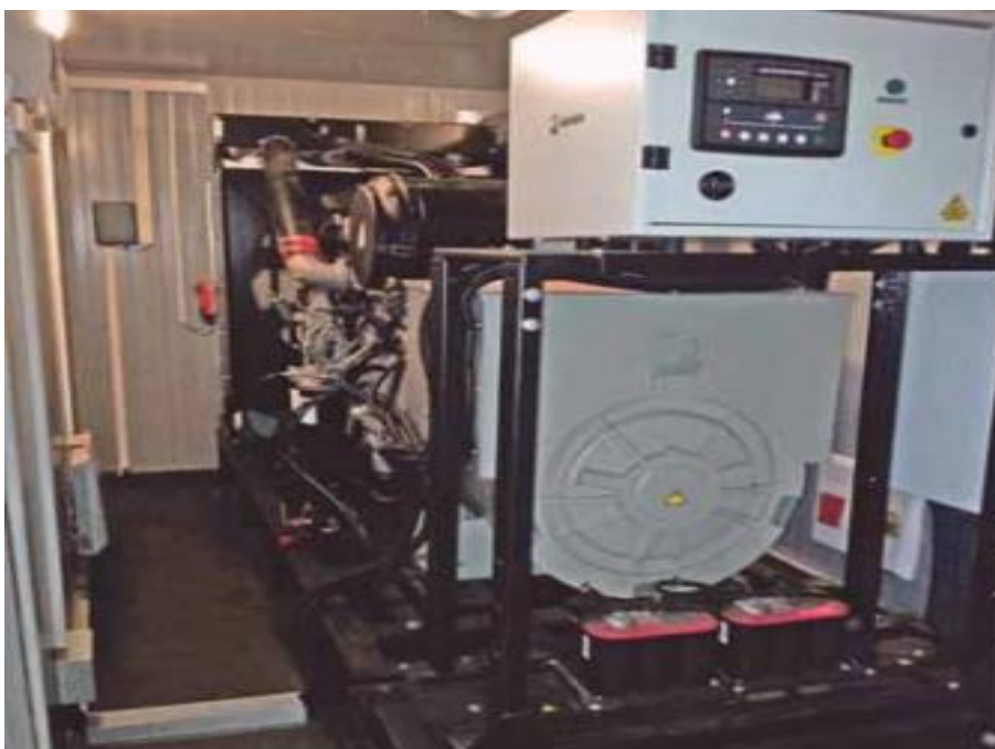
Рисунок 3 - Дизель-генераторная установка, размещенная в контейнере
